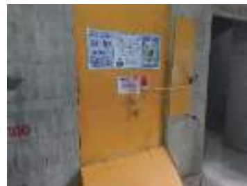
電梯開口防護
