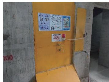
電梯開口防護
