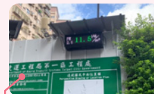
工區出入口設置PM2.5偵測儀器
